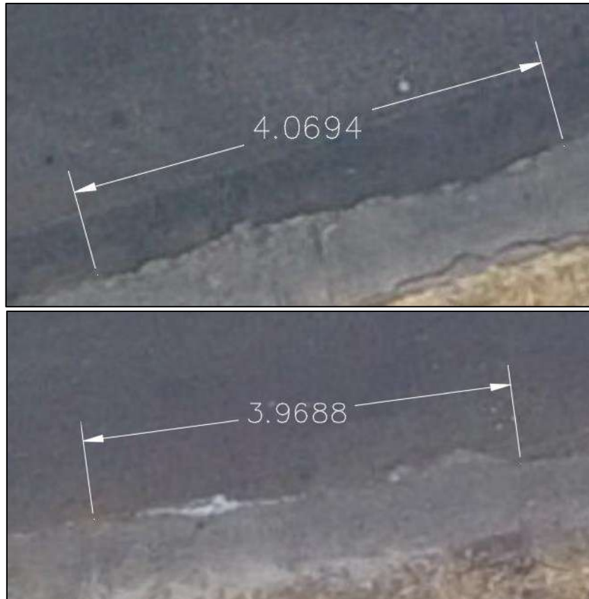
Gambar 8. Intepretasi visual kerusakan jalan jenis retak sambung.
