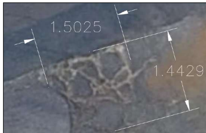
Gambar 7. Intepretasi visual kerusakan jalan jenis retak blok.
