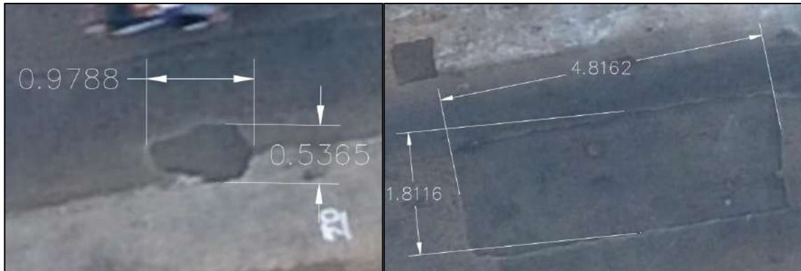
Gambar 9. Intepretasi visual kerusakan jalan jenis retak tambalan.
