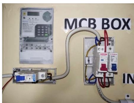
Gambar 9. MCB dan RCBO trip saat terjadi korsleting listrik
