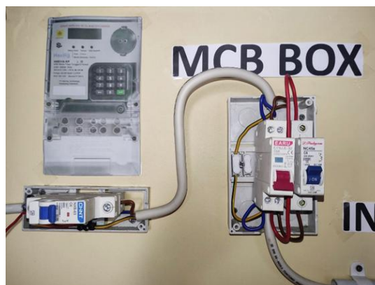
Gambar 11. RCBO mampu trip sedangkan MCB tidak trip
