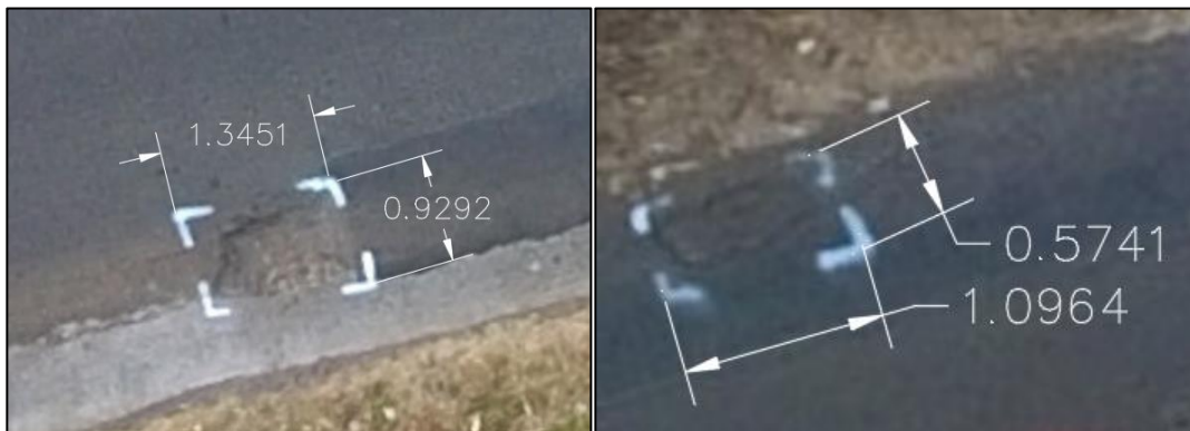
Gambar 9. Pengukuran dimensi kerusakan jalan jenis retak tambalan dari data peta orthofoto.
