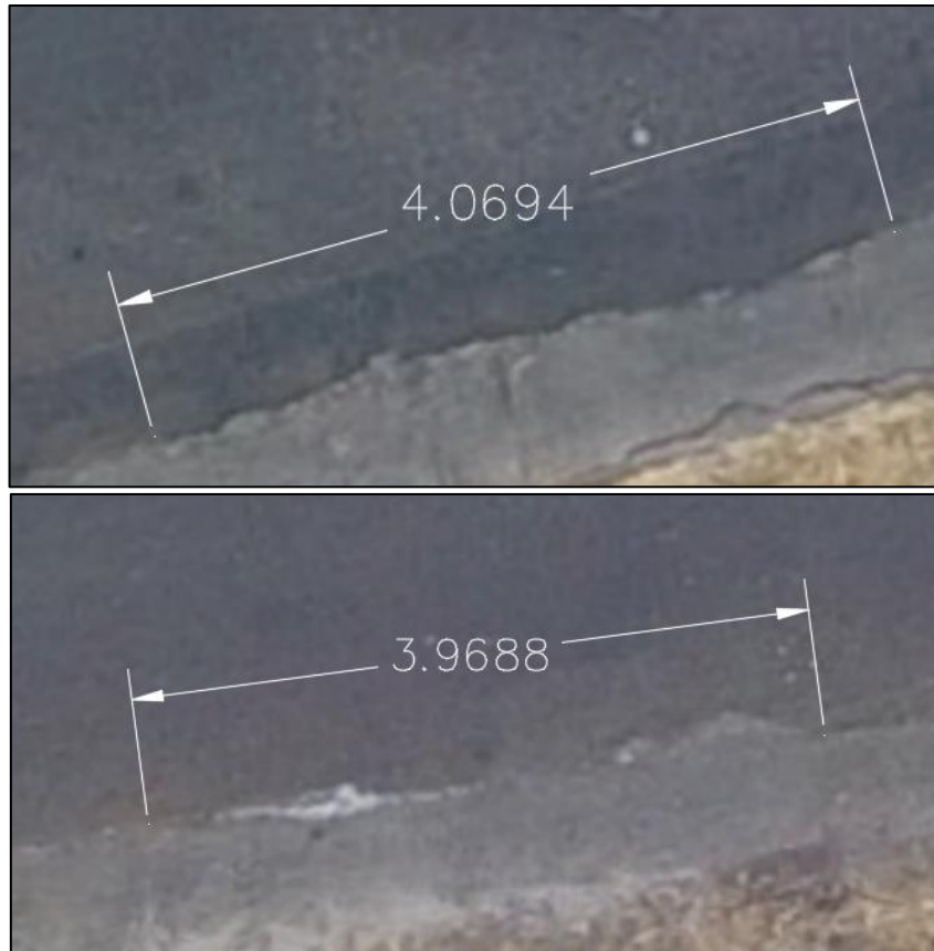
Gambar 8. Intepretasi visual kerusakan jalan jenis retak sambung.
