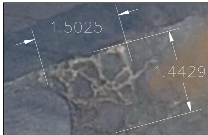
Gambar 7. Intepretasi visual kerusakan jalan jenis retak blok.
