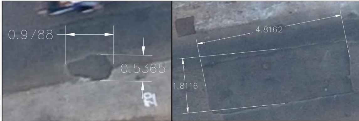
Gambar 9. Intepretasi visual kerusakan jalan jenis retak tambalan.
