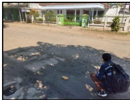
GAMBAR 4. KONDISI JALAN STA 0 – 50
